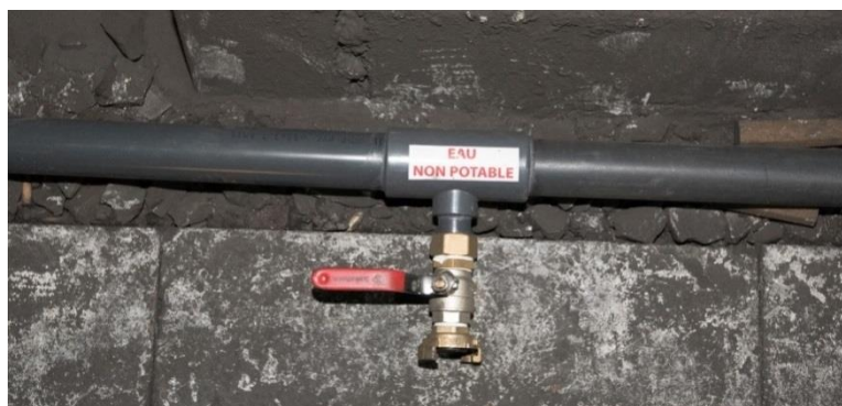
Figure 113. Photo d'un point de branchement sur le réseau d'arrosage
