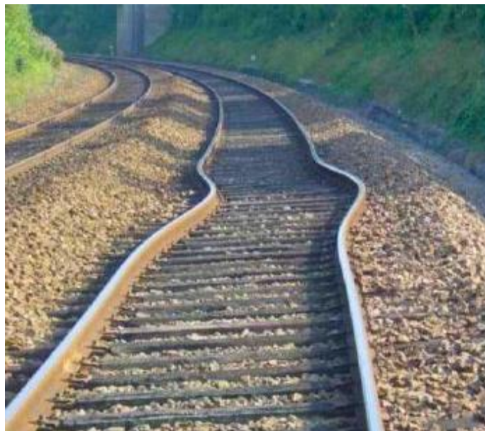
Figure 37. Phénomène de flambement en période chaude
