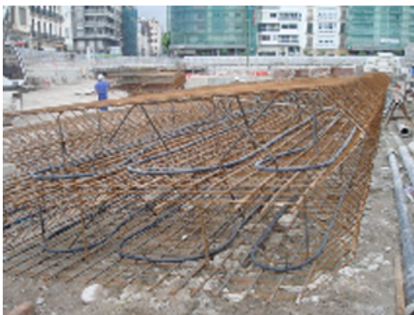
Figure 2. Préparation de l'armature et des tubes échangeurs pour la construction d'une paroi moulée géothermique
